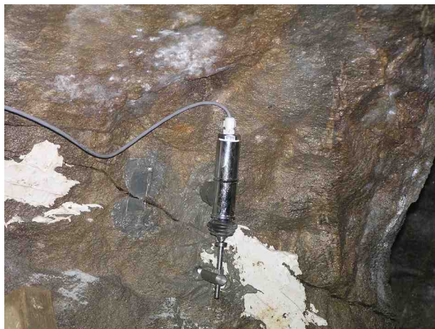
Čidlo pro měření rozevirání puklin v komoře K1 / Sensor for measurement of developing of failures in rock massif in chamber K1
