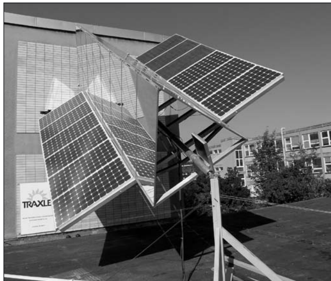
Obr. 1 Solární fotovoltaický systém s pohyblivým stojanem a s hřebenovým koncentrátorem záření instalovaný na Technické fakultě ČZU v Praze
