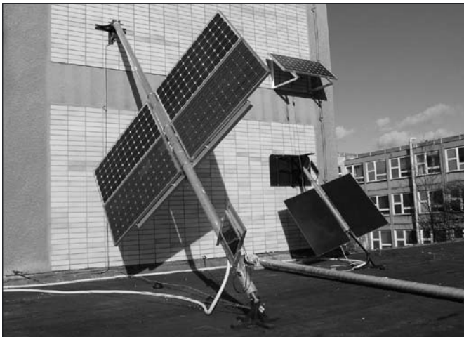
Obr. 1 Solární PV systém s nominálním výkonem P_{\max} = 500 \text{ W}_p instalovaný a testovaný na Technické fakultě ČZU v Praze
