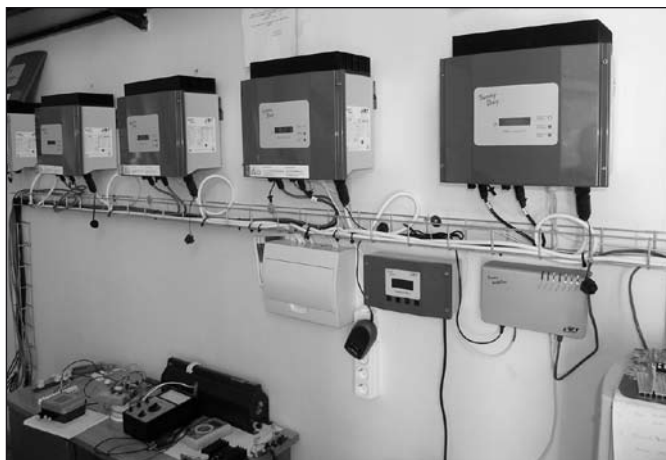
Obr. 5 Pohled na datalogger, rozvaděč a měniče Sunny Boy umístěné v laboratoři
