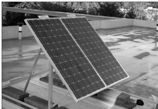
Obr. 1 Umístění zkoumaných solárních panelů na střeše budovy UTB ve Zlíně
