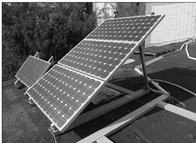
Obr. 2 PV systém s pevným stojanem vyvinutý a instalovaný na ČZU v Praze
