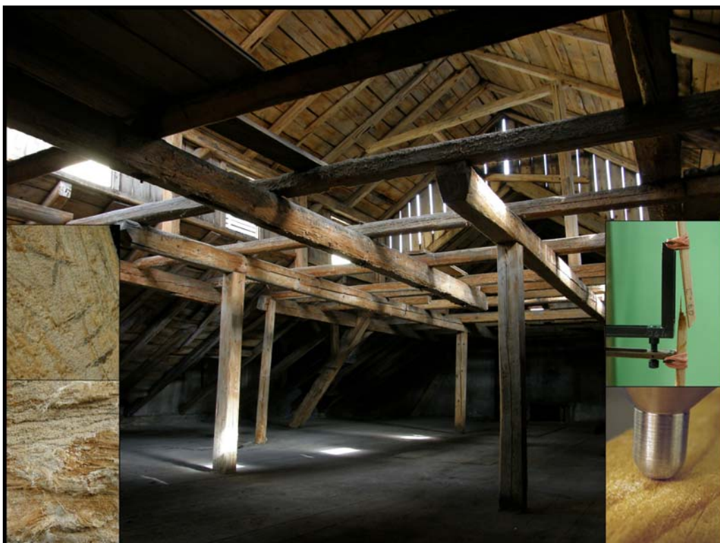
Pohled do poškozené krovové konstrukce. Detail poškozené povrchové vrstvy dřeva (vlevo). Příklad zkoušek vzorků dřeva (vpravo).
