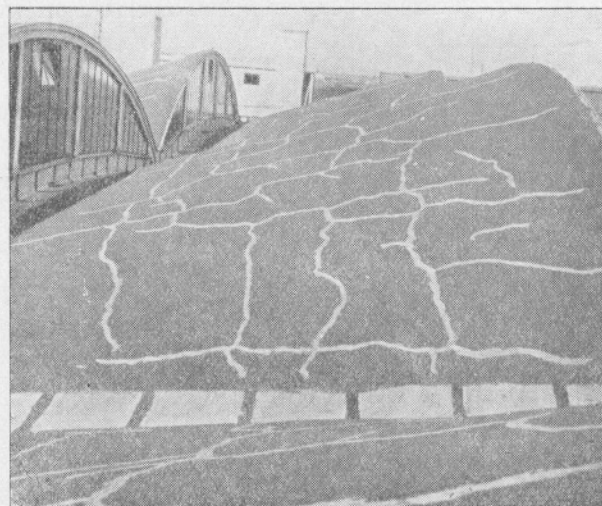
131. Poruchy příliš tvrdé hydroizolace. 131. Разрушения слишком твердой изоляции. 131. Failure of hard hydroinsulation.
