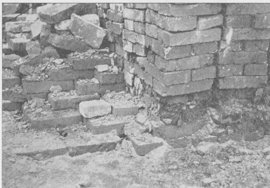
125. Narušení cihel mrazem. 125. Разрушение кирпичей, вызванное морозом. 125. Deterioration of bricks by frost.
