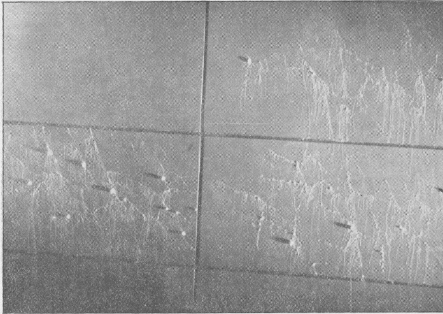
128. Účinky tučné cementové podkladní malty s přísadou sody na skleněný obklad. 128. Влияние жирного цементного фундаментного раствора с примесью воды на стеклянную облицовку 128. Effect of fat cement base-mortar with soda on glass facing.
