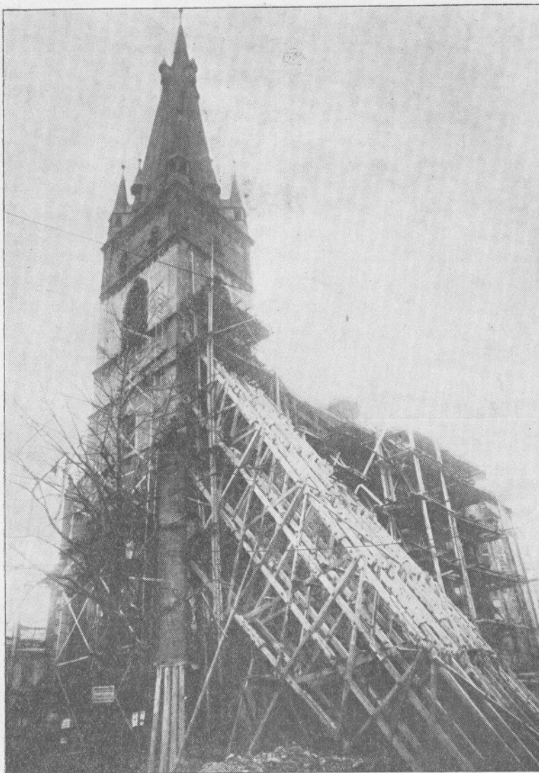
158. Zajištění porušené věže kostela v Ústí n/L.
