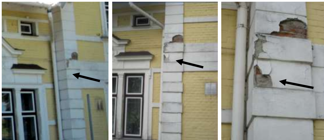
Obr 6 Fotodokumentace postupného poškození vnější omítky na objektu v centru obce Doubrava (postupně stav 23.6.2010, 30.6.2011 a 19.7.2011)
