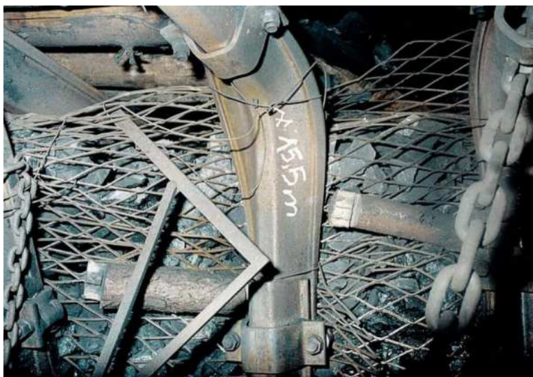
Obr. 8. Detail deformace výztuže.
