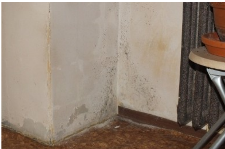
Zatopený objekt po opadu vody s růstem plísní na povrchu provlhlého zdiva
