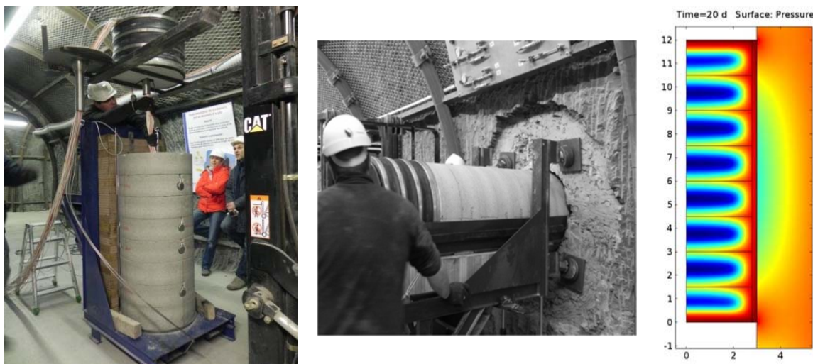
Obr. 6 Konstrukce těsnícího systému sestaveného z osmi bentonitových bloků, jeho horizontální instalace v experimentu SEALEX a stav saturace po 20 dnech (výpočet s použitím HM modelu).
