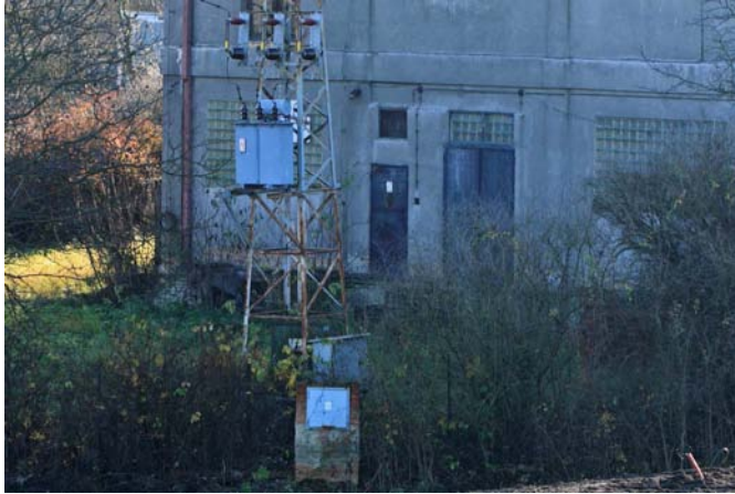
Trafostanice na severní straně
