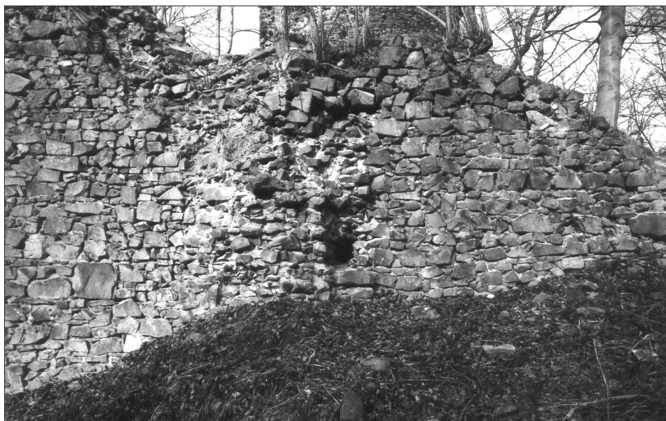
Obr. 11. Týřov, hrad. Pohled na vnější líc jižní části hradební zdi horního hradu. Uprostřed relikt hranolového pilíře s kapsou závory brány, vlevo od pilíře svislý technologický a petrografický předěl v líci zdiva (srov. obr. 10). V pozadí hlavní válcová věž. Foto V. Razím, 2002. — Abb. 11. Burg Týřov. Südlicher Ringmauerteil der oberen Burg, äußere Mauerflucht. In der Mitte Relikt des quadratischen Pfeilers mit der Torbalkenriegelscheide, links vom Pfeiler eine vertikale, in der Mauerflucht deutliche technologische und petrographische Trennung (vergl. Abb. 10). Im Hintergrund der runde Hauptturm. Foto V. Razím, 2002.
