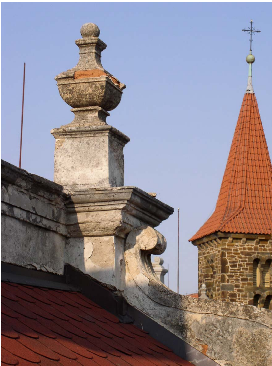
Chátrající architektonické ozdoby na střeše zámku
