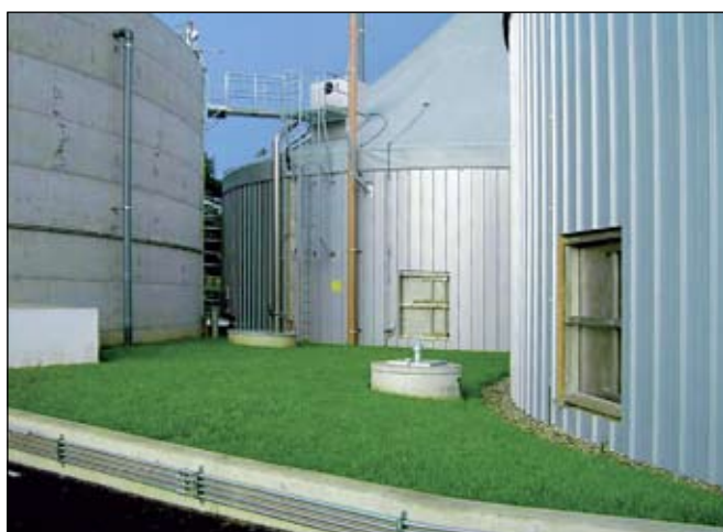
Bioplynová stanice (zdroj: Renergy, s. r. o.)
