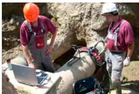
NDT má nezastupitelný význam pro kontrolu dálkových potrubí a monitoring nejrůznějších zařízení a budov
