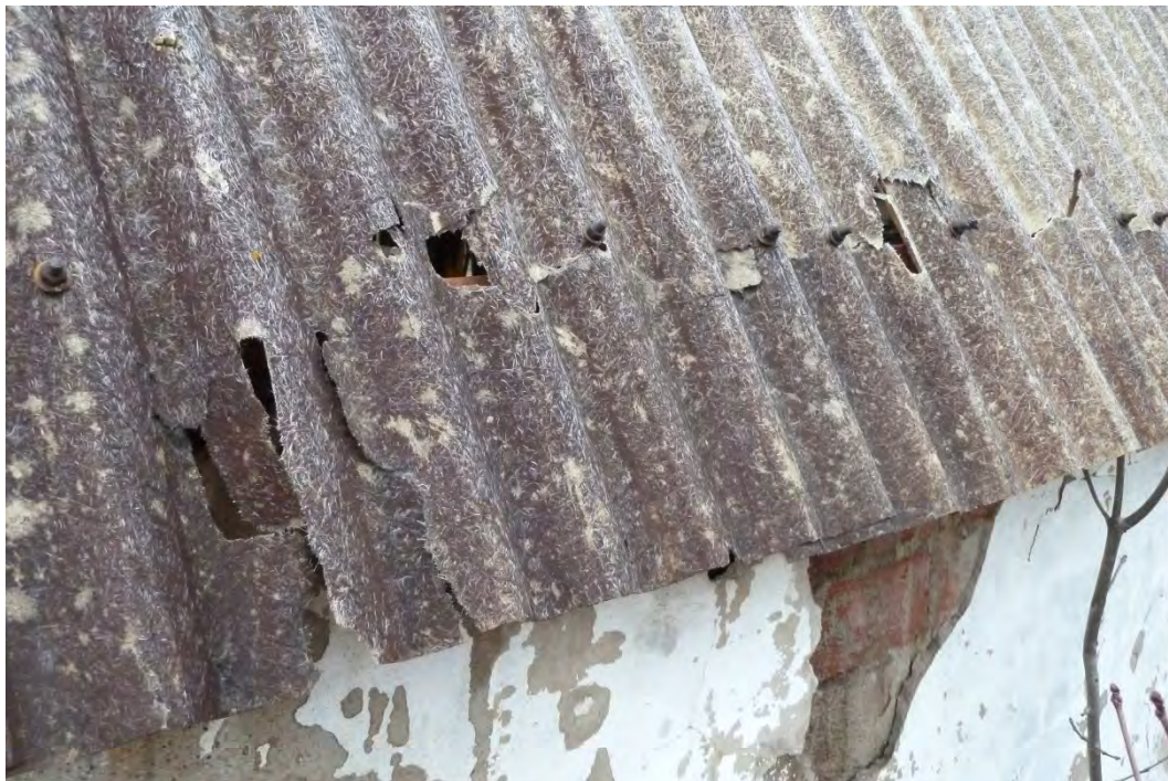
21. Detail degradované střešní krytiny
