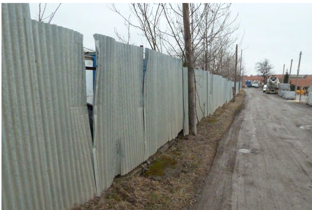
4. Poškozené oplocení podél západní hranice areálu
