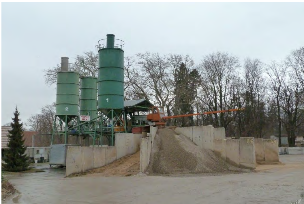
37. Výrobní zařízení betonárky
