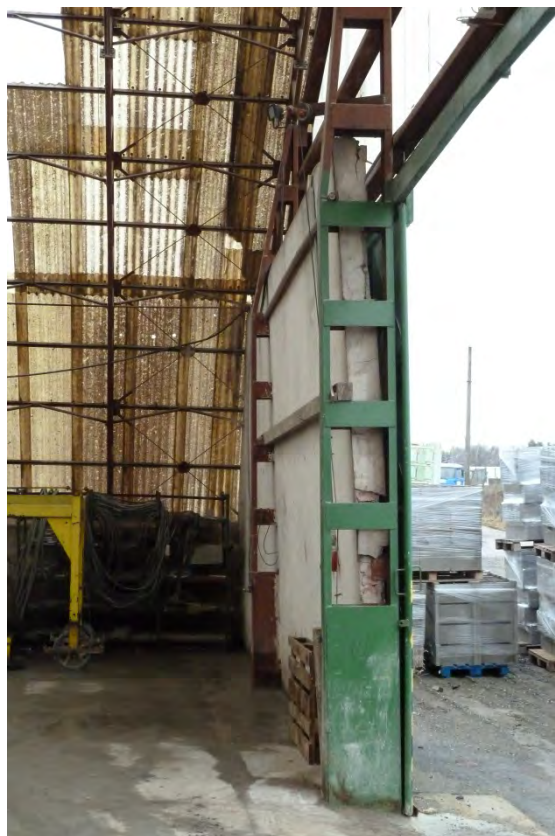
27. Poškozená štítová zeď na západní straně obloukové haly
