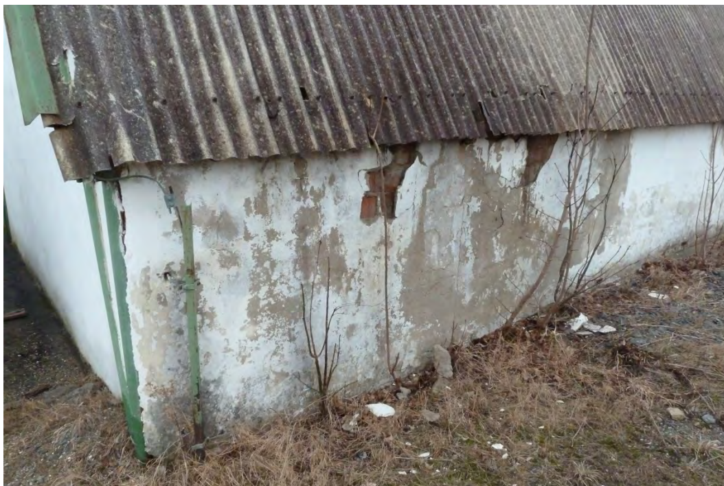
20. Detail poškozené podezdívky na jižní straně obloukové haly
