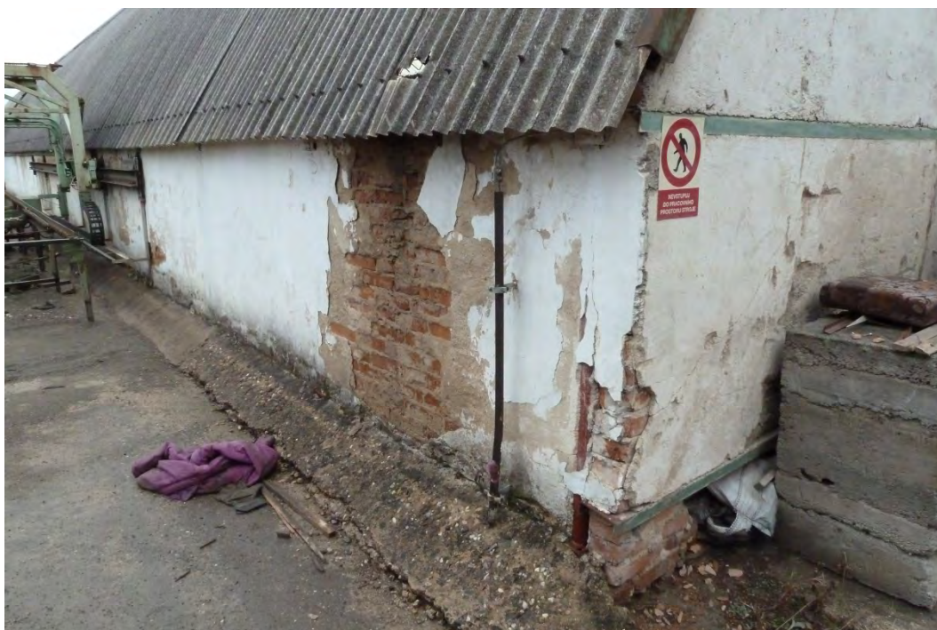
17. Detail poškozené podezdívky na jihovýchodním rohu obloukové haly
