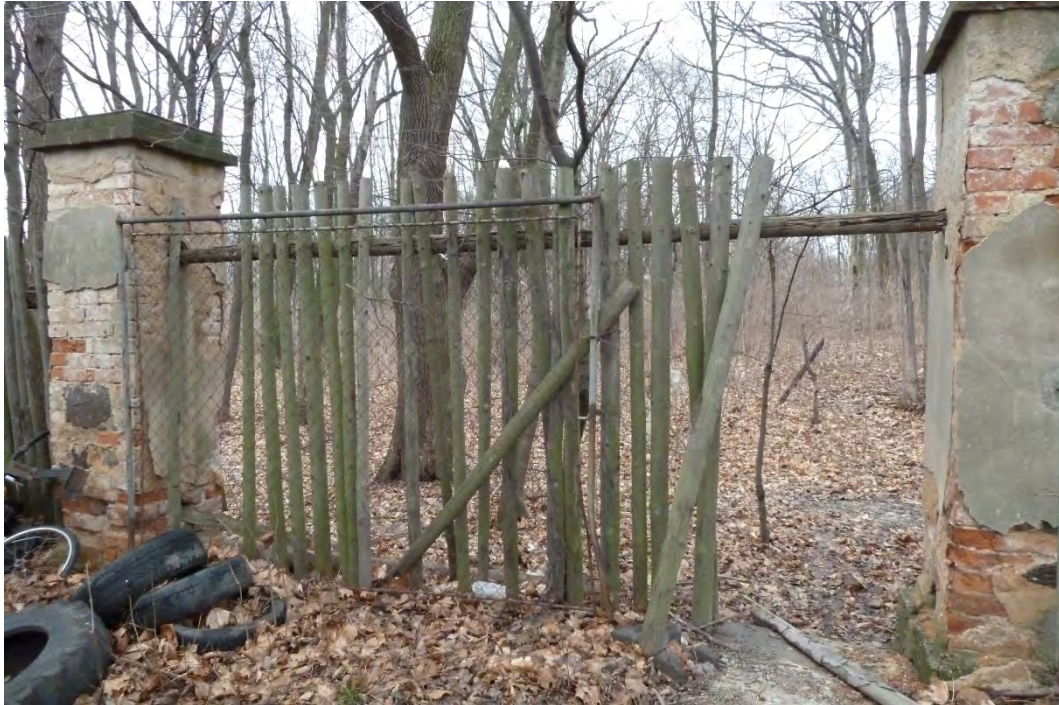
7. Technický stav oplocení podél východní hranice areálu
