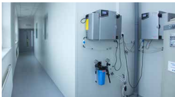
Zařízení pro výrobu aqua purificata technologií inverzní osmózy s 300l tankem.
