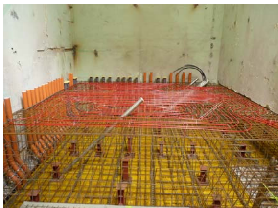
Příprava betonáže stropu (tloušťka 1,8 m) cyklotronové haly – armatury, kabelové průchody a labyrint na maření zbytkového tepla.
