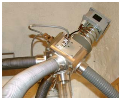
Pneumatická potrubní pošta – čtyřcestná hlavice.
