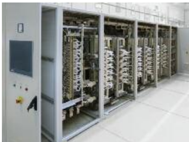
Vnitřní uspořádání měniče (zleva: skříň regulace, následují skříně usměrňovače, 3 fází střídače, filtru a kapalinového chlazení)
