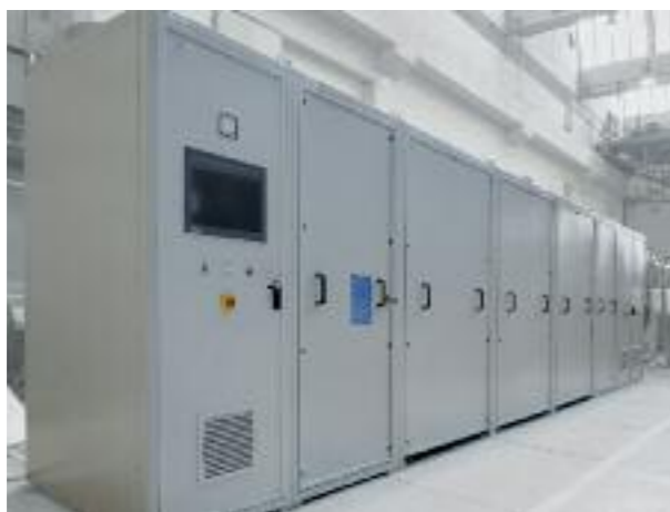
Celkový pohled na sestavu frekvenčního měniče INVERT 7L W
