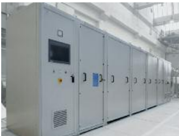
Celkový pohled na sestavu frekvenčního měniče INVERT 7L W
