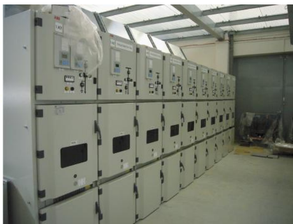
Obr. 8: Vysokonapěťová oblast napájení – 6kV rozvodna.
