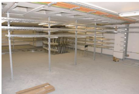
Obr. 6: Suterén haly - kabelový prostor.
