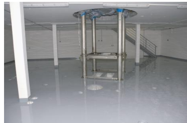
Obr. 4: Hala tokamaku – přízemí.
