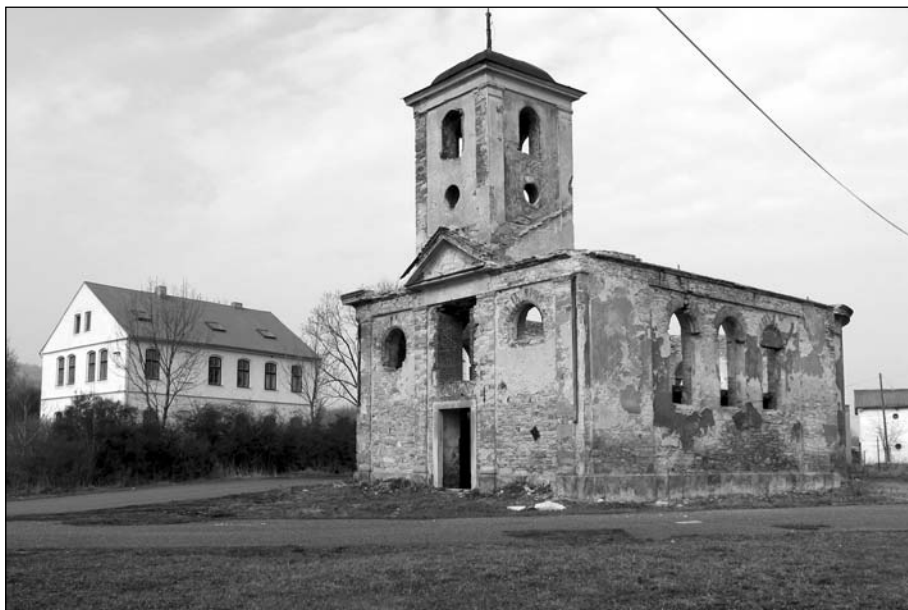
Protináboženské postoje poúnorového režimu vedly k likvidaci mnoha kostelů, která byla v případě odsunutých německých evangelíků téměř absolutní. Empírový kostel v Habřině u Úštěku z roku 1851 byl například přepatrován a sloužil jako skladiště JZD (foto autor, 2005)
