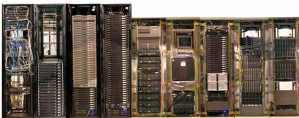
Pohledy na část serverů.
