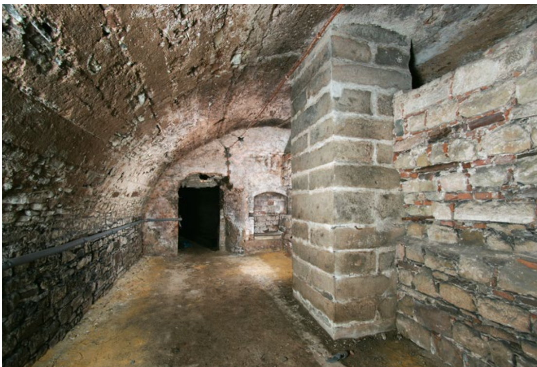
[6] Suterénní prostor v jižním křídle prelatury, průhled k severu s kvádrovým pilířem, v pozadí čelní stěna se zazděným vstupem. Foto: NPÚ Josefov, Matouš Jirák
