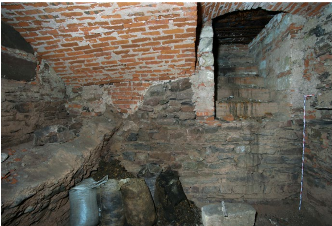
[5] Středověké zdivo a část klenby v suterénu východního křídla, vpravo schodiště ze sakristie. Foto: NPÚ Josefov, Matouš Jirák
