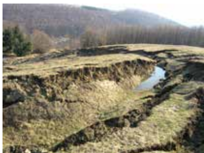
Tahové trhliny v odlučné oblasti mělkého sesuvu (smyková plocha v hloubce kolem 10 metrů) s planární smykovou plochou; místní část Hluboče, Brumov-Bylnice, Bílé Karpaty, jaro 2006
