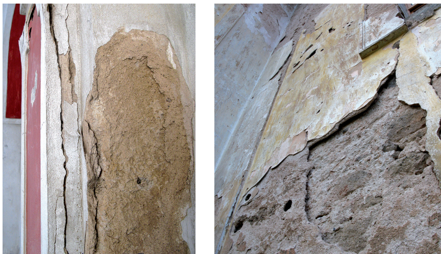
OBRÁZEK 64: Oddělení velkých ker omítky v důsledku degradace jádrové omítky na rozhraní s podkladem nebo jejím rozpadem (Foto M. Drdácý)
