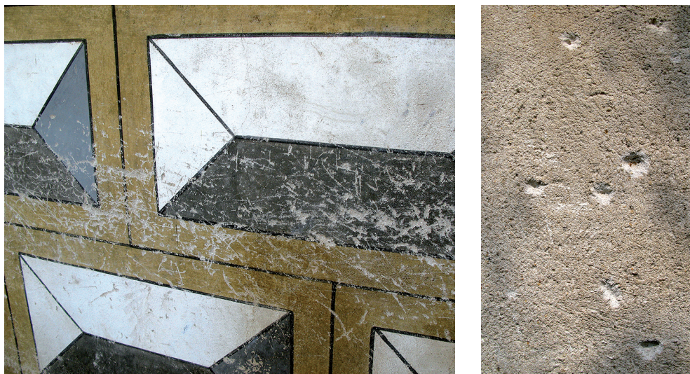
OBRÁZEK 68: Ztráta materiálu seškrábáním stěny, o kterou jsou opírána kola (vlevo), krátery způsobené projektily ze vzduchovky (vpravo) (Foto M. Drdácý)
