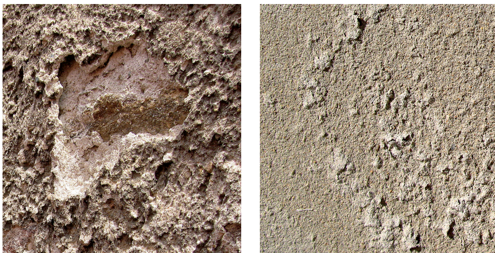
OBRÁZEK 67: Ztráta soudržnosti (koheze) jádrové omítky pod ztvrdlou vrstvou krusty (vlevo), příklad rozpadu omítky šupinatěním (vpravo) (Foto M. Drdácý)
