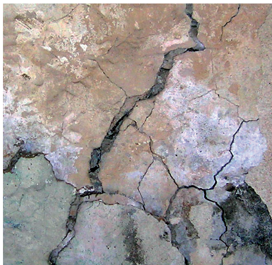
OBRÁZEK 58: Konstrukční trhlina procházející do omítkové vrstvy (Foto J. Adánek)
