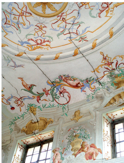
OBRÁZEK 57: Kombinace dilatačních a konstrukčních trhlin v důsledku rozdílné roztažnosti bednění a konstrukce dřevěného stropu a omítkové vrstvy a dále průhybu dřevěné stropní konstrukce (Foto M. Drdácý)
