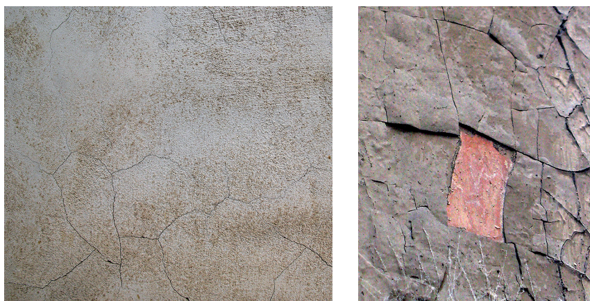
OBRÁZEK 56: Rozpraskání (krakelování) je typické pro smršťovací trhliny. Na pravé straně jsou kombinovány s deformacemi, odtržením od podkladu a ztrátou materiálu (Foto M. Drdácý)
