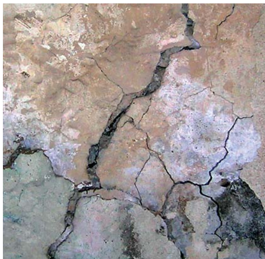
OBRÁZEK 58: Konstrukční trhlina procházející do omítkové vrstvy (Foto J. Adámek)
