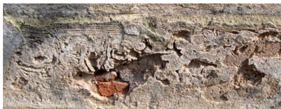
OBRÁZEK 70: Selektivní degradace a eroze (Foto M. Drdácý)
