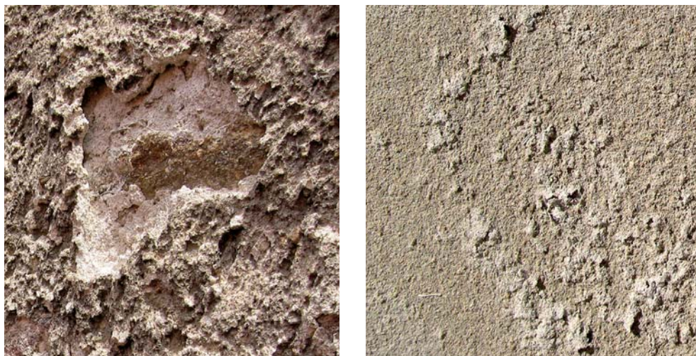
OBRÁZEK 67: Ztráta soudržnosti (koheze) jádrové omítky pod ztvrdlou vrstvou krusty (vlevo), příklad rozpadu omítky šupinatěním (vpravo) (Foto M. Drdácěk)
