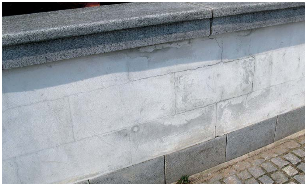
OBRÁZEK 55: Jemné trhliny jako výsledek dilatačních pohybů bloků zdiva teplotní roztažností. V takovém případě nelze vzniku trhlin zabránit a poruchy mohou být pouze zakryty vrstvou malty vyztuženou pletivem nebo jejich viditelnost snížena pravidelnými nátěry (Foto M. Drdácý)
