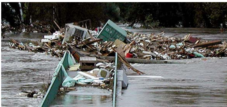
OBRÁZEK 121: Bariéra vytvořená na pěší lávce v Troji v roce 2002 (Foto T. Drdácký)
