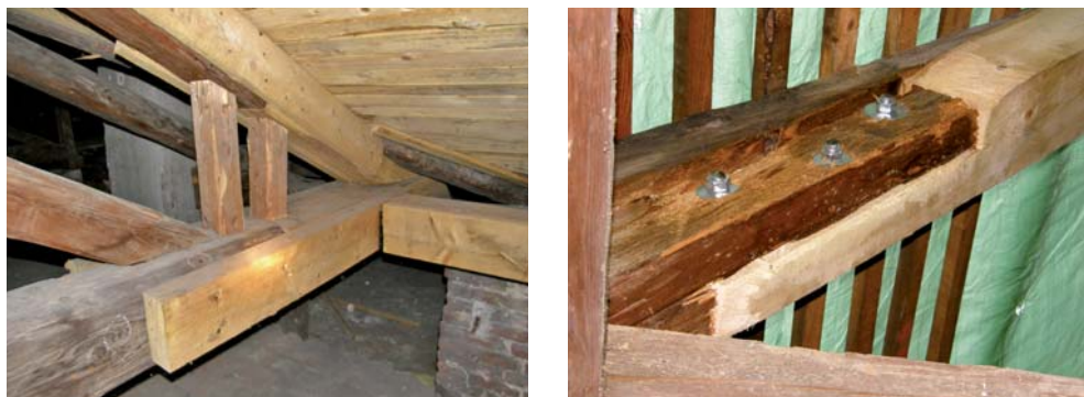
OBRÁZEK 139: Stávající esteticky nevhodné techniky oprav dřevěných konstrukcí – příložkování (vlevo) a použití ocelových svorníkových spojů (vpravo)
