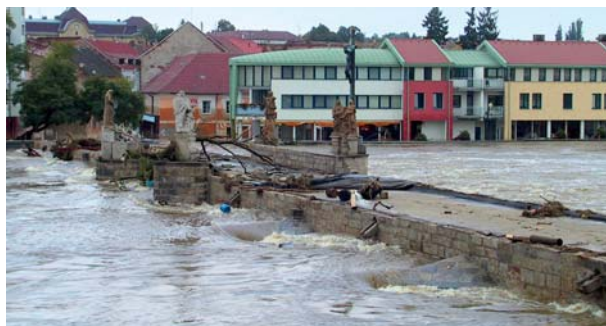
OBRÁZEK 120: Povodní zničené parapetní zdi mostu v Písku v roce 2002 (Foto Michal Jánický)
