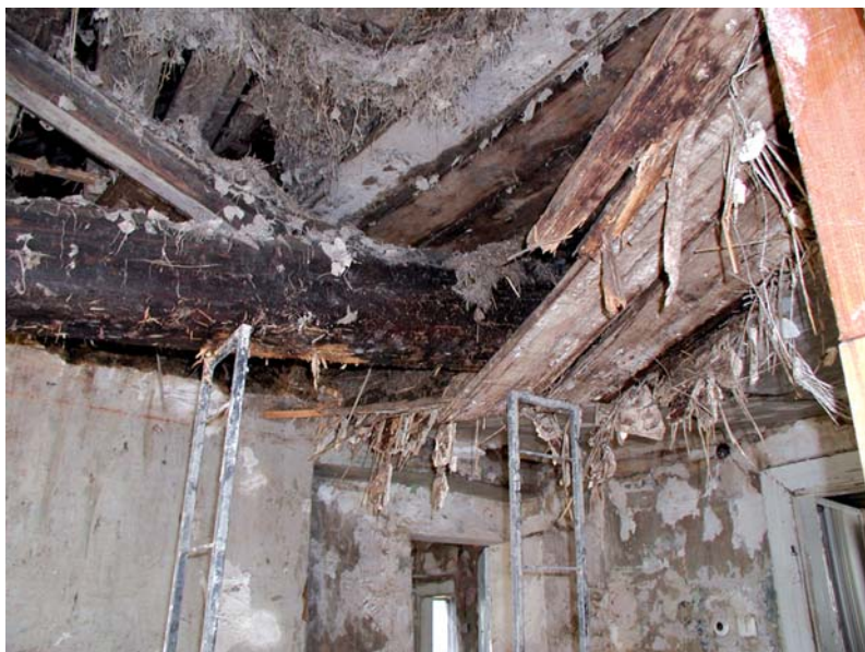
OBRAZEK 123: Zřícení stropních trámů kombinací biodegradace dřeva a přetížením vodou nasycených konstrukcí skladovaného materiálu na půdě totálně zatopeného domu – Troja 2002 (Foto M. Drdácí)
