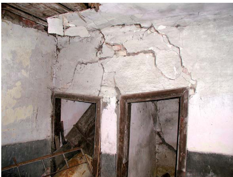
OBRÁZEK 122: Prosednutí násypu pod založením příček ve mlýně v Soběslavi (Foto M. Drdácký)
