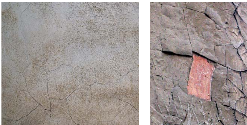
OBRÁZEK 56: Rozpraskání (krakelování) je typické pro smršťovací trhliny. Na pravé straně jsou kombinovány s deformacemi, odtržením od podkladu a ztrátou materiálu (Foto M. Drdácěk)
