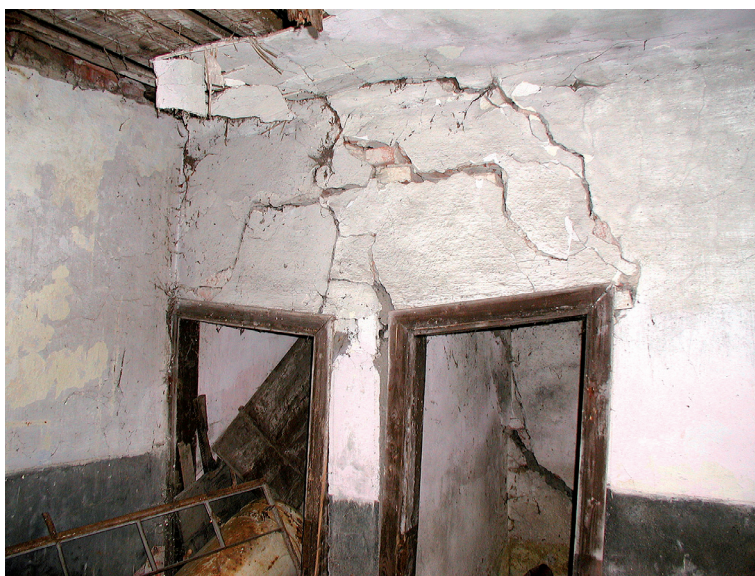
OBRÁZEK 122: Prosednutí násypu pod založením přiček ve mlýně v Soběslavi (Foto M. Drdáčký)
