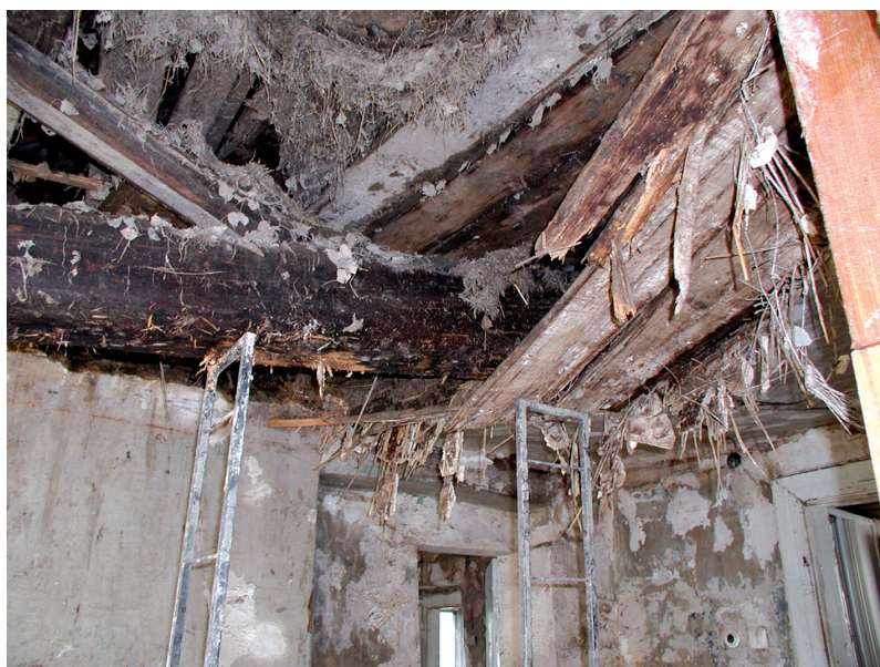
OBRÁZEK 123: Zřícení stropních trámů kombinací biodegradace dřeva a přetížením vodou nasycených konstrukcí skladovaného materiálu na půdě totálně zatopeného domu – Troja 2002 (Foto M. Drdácěk)
