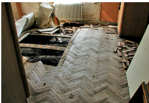
OBRÁZEK 124: Boulení vodou nasycené podlahy – Troja 2002 (Foto M. Drdácký)
