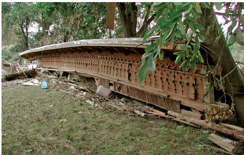
OBRÁZEK 115: Utržená a odplavená střecha kuželníku – Podhoří 2002 (Foto M. Drdácíky)
