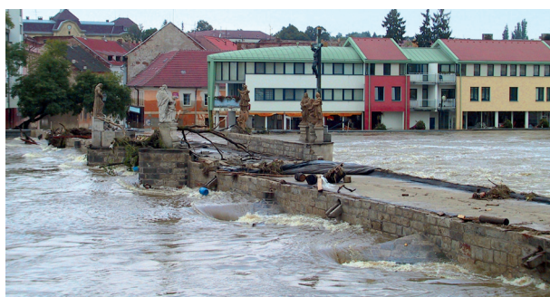
OBRÁZEK 120: Povodní zničené parapetní zdi mostu v Písku v roce 2002 (Foto Michal Jánský)
