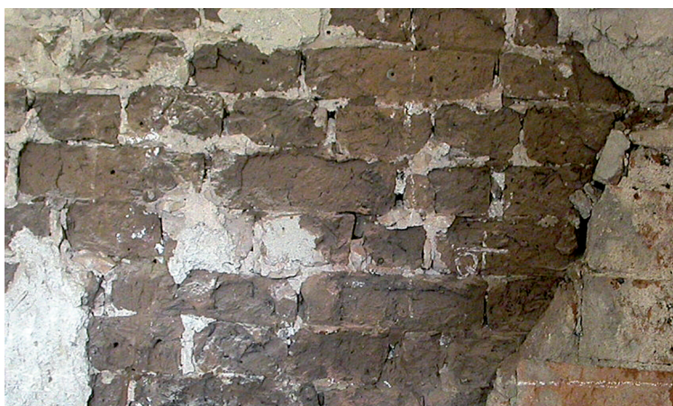
OBRÁZEK 126: Příklad odpadávání povrchové vrstvy nepálených cihel po odstranění omítky, což je nevhodné u tohoto typu zdiva. V daném případě však je zdivo velmi heterogenní a nebylo jednoduché odhalit místa s nepálenými cihlami (Foto M. Drdácký)
