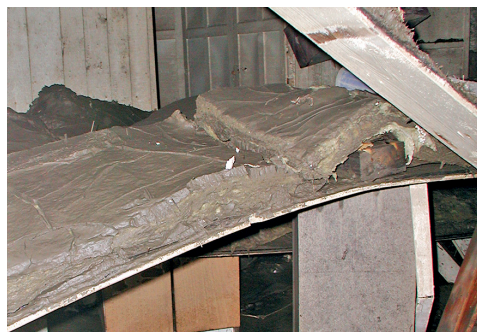
OBRÁZEK 125: Zřícený pohled s vodou a bahnem nasycenou tepelně izolační rohoží (Foto M. Drdácký)
