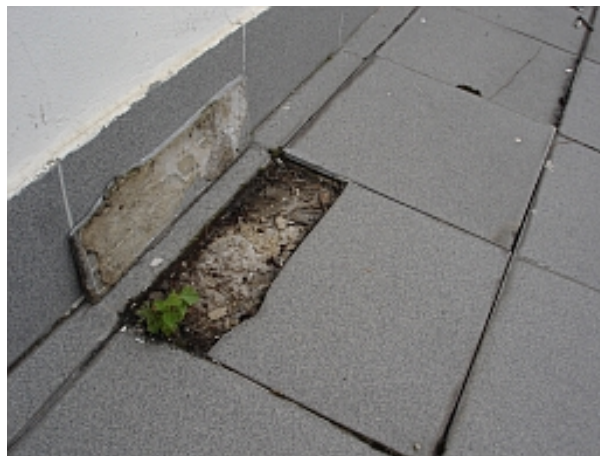
Detail narušení dlažby terasy s rostoucí vegetací.
