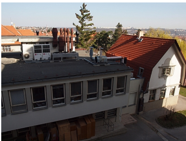
Střeška budovy F s osazenými vzt. aparaturami.
