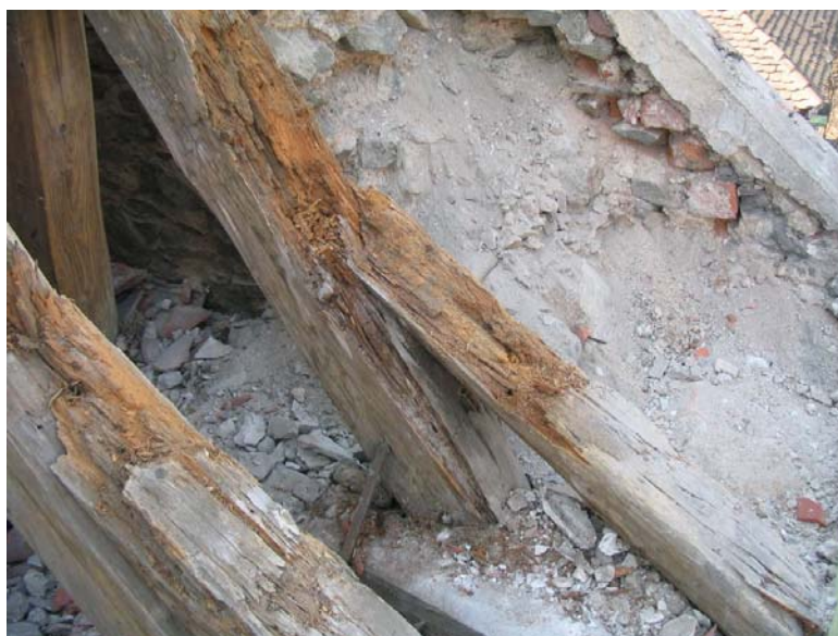
Poškozená krovová konstrukce barokního kostela
