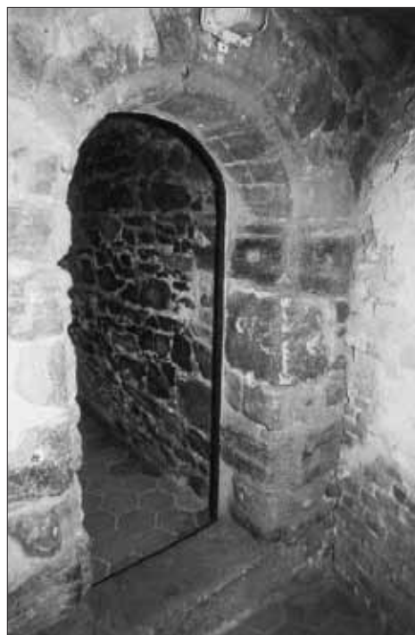
Obr. 8. Jindřichův Hradec, hrad. Vstupní portálek 1. patra útočištné věže. Foto V. Razím 2003. — Abb. 8. Jindřichův Hradec, Burg. Eintrittsportal in den 1. Stock des Rundfluchturmes. Foto V. Razím 2003.
