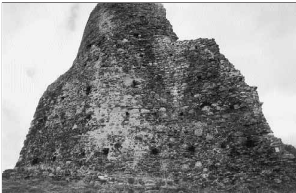
Obr. 26. Lichnice, hrad. Věž v severovýchodním nároží, detailní pohled na severní část vnějšího pláště a navazující hradbu (vpravo) s původními hlubokými otvory po dřevěch lešení a výztuh zdíva (srov. obr. 24 a 25). Foto V. Razím 2004. — Abb. 26. Lichnice, Burg. Turm an der Nordostecke, Detailansicht des Nordteils des äußeren Mauermantels und der anschließenden Wehrmauer (rechts) mit den ursprünglichen Rüstlöchern (vgl. Abb. 24 und 25). Foto V. Razím 2004.
