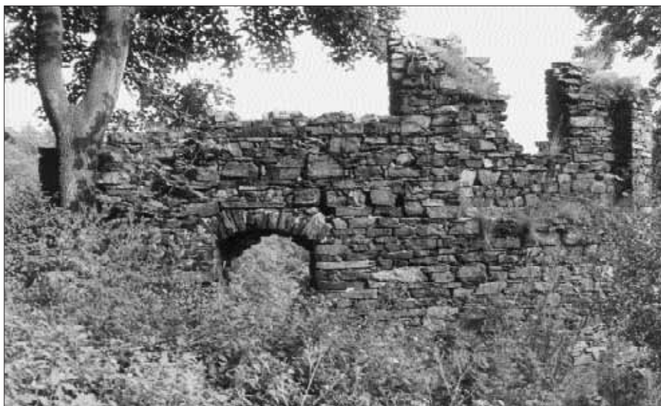
Obr. 10. Rýzmburk, hrad. Vnitřní líc jižní části vnější hradby se sedlovou vížkou (vpravo) a nikou střílny pro palnou zbraň (uprostřed). Srov. obr. 9: 4; 11: A; 12. Foto V. Razím 1994. — Abb. 10. Rýzmburk, Burg. Innenseite des Südteiles der äußeren Wehrmauer mit Sattelturm (rechts) und Nische der Schiesscharte für Feuerwaffe (inmitten). Vgl. Abb. 9: 4; 11: A; 12. Foto V. Razím 1994.
