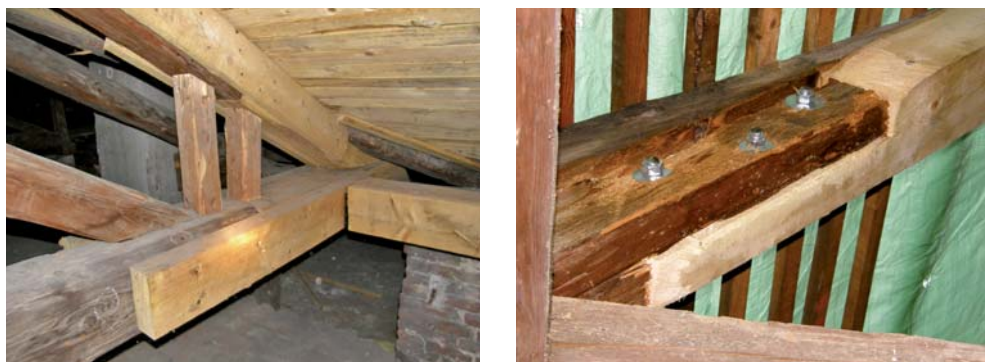
OBRÁZEK 139: Stávající esteticky nevhodné techniky oprav dřevěných konstrukcí – příložkování (vlevo) a použití ocelových svorníkových spojů (vpravo)
