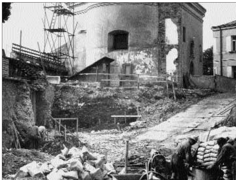
Obr. 3. Přerov, Horní nám. č. p. 8, 9. Pohled od S na stavební jámu, v pozadí zkoumaná plocha A s roštovou hradbou a kaple sv. Jiří.
