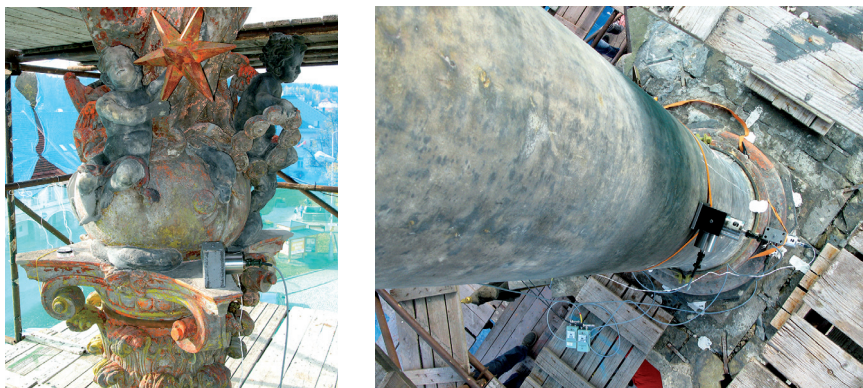
OBRAZEK 261: Umístění snímačů kmitání v úrovni hlavice sloupu (vlevo) a na dřívku (vpravo)
