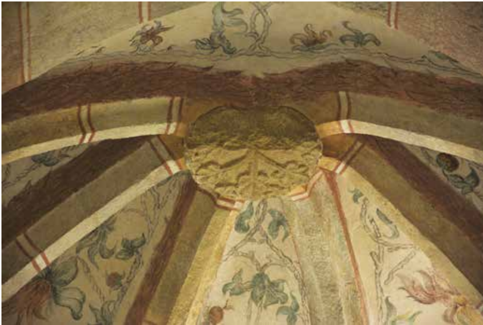
15 Svorník v jižní kapli. Cisterciácký klášter, Žďár n. Sázavou. Foto J. Válek 2017.
