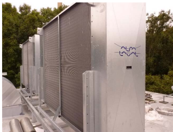
Chladicí věže na střeše nové budovy.
