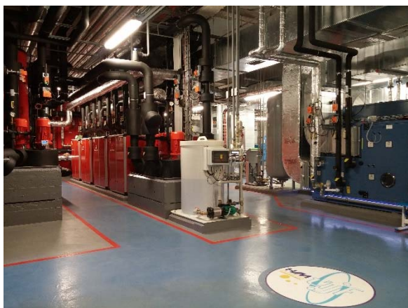
Strojovna VZT, chlazení cyklotronu TR 24 a vytápění nové budovy.
