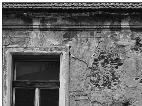
Obr. 6. Trněný Újezd, čp. 20. Detail návěsního průčelí domu, pod okapní římsou patrné zbytky bíle malované výzdoby raně barokního charakteru (foto Z. Neustupný, 2009).
