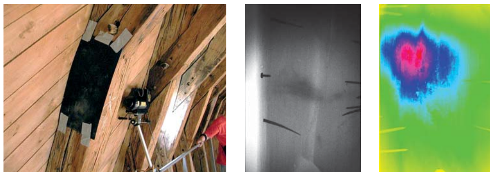
OBRAZEK 187: Uspořádání rentgenového měření v krovu kostela sv. Anny v Praze (vlevo) – na krokvi je snímač záření (černá deska), z druhé strany záříč. Snímky dále ukazují rentgenový záznam snímané krokve (uprostřed) a místa na jiné krokvi s nalezenou hnilobou (vpravo) po barevném zvýraznění intenzit procházejícího záření.
