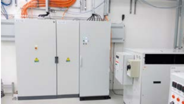
■ Obr. 33 Rozvaděčová sestava v S2.
