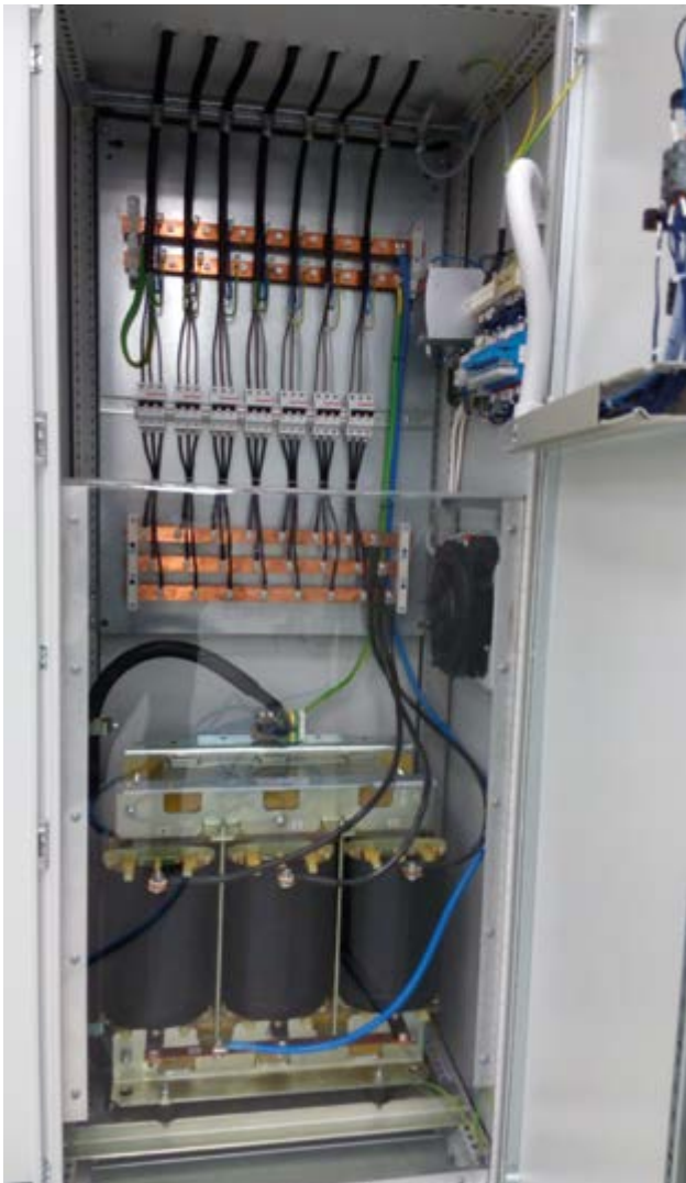
■ Obr. 34 Rozvaděč s transformátorem v S2.
