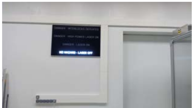
■ Obr. 30 Informační tabule LSS + plastové kabelové žlaby v L3.
