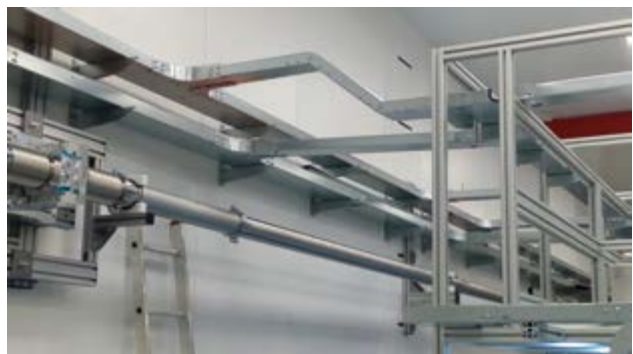
■ Obr. 32 Kovové kabelové žlaby v L1.
