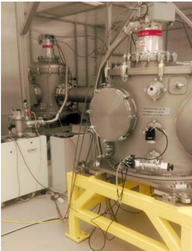
■ Obr. 27 Vakuové komory pro projekt TERESA v hale L2.
