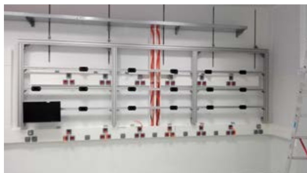
■ Obr. 21 Nosná konstrukce video stěny řídicí místnosti laseru L3.
