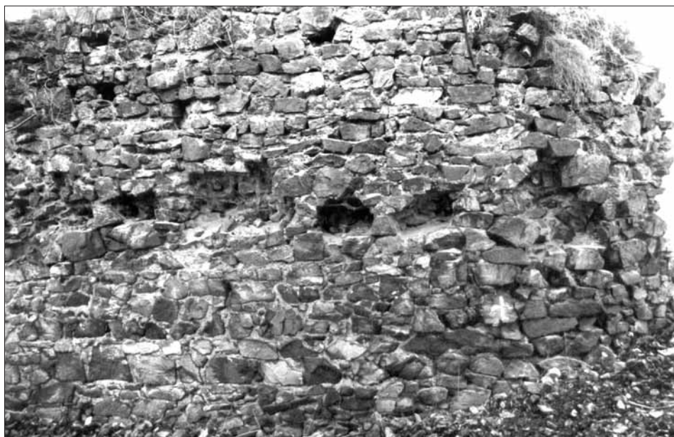
Obr. 12. Týřov, hrad. Pohled na vnitřní líc jižního úseku hradby horního hradu s druhotně vylámanými kapsami pro trámy. Pod kapsami probíhá horizontální petrografické rozhraní. Foto M. Micka, 2001. — Abb. 12. Burg Týřov. Obere Burg, Ansicht der Innenseite des südlichen Ringmauerabschnitts mit sekundär errichteten Balkenlagern. Unter den Balkenlagern deutlicher Verlauf der horizontalen petrographischen Trennung. Foto M. Micka, 2001.
