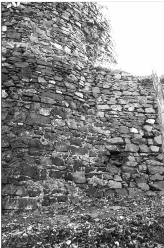
Obr. 8. Týřov, hrad. Detail návaznosti hlavní válcové věže na vnější líc severního úseku hradební zdi horního hradu. Zejména v dolní partii byl plášť zdiva věže připraven pro navázání hradby. Zdivo věže má oproti hradební zdi odlišnou petrografickou skladbu, maltu i výškovou úroveň horizontálních technologických spár. Foto V. Razím, 2001. — Abb. 8. Burg Týřov. Obere Burg, Anschlußdetail zwischen dem Hauptturm und der Außenseite des nördlichen Abschnitts der Ringmauer. Besonders in der unteren Partie wurde der Turmmantel zum Anschluß der Ringmauer vorbereitet. Das Turmmauerwerk besitzt im Unterschied zu jenem der Ringmauer unterschiedliche petrographische Struktur, Mörtel und Höhe der horizontalen Lagerspalten. Foto V. Razím, 2001.
