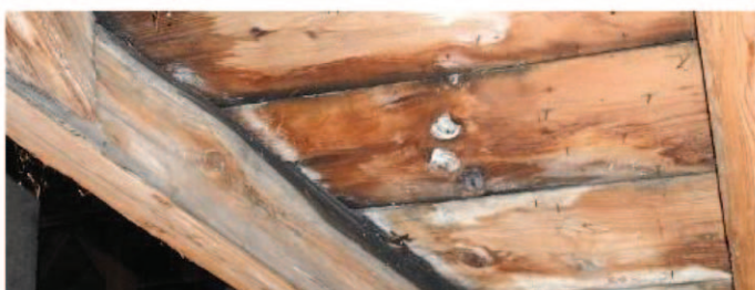
Obr. 3: Spodní část krokve poškozená hnilobou
