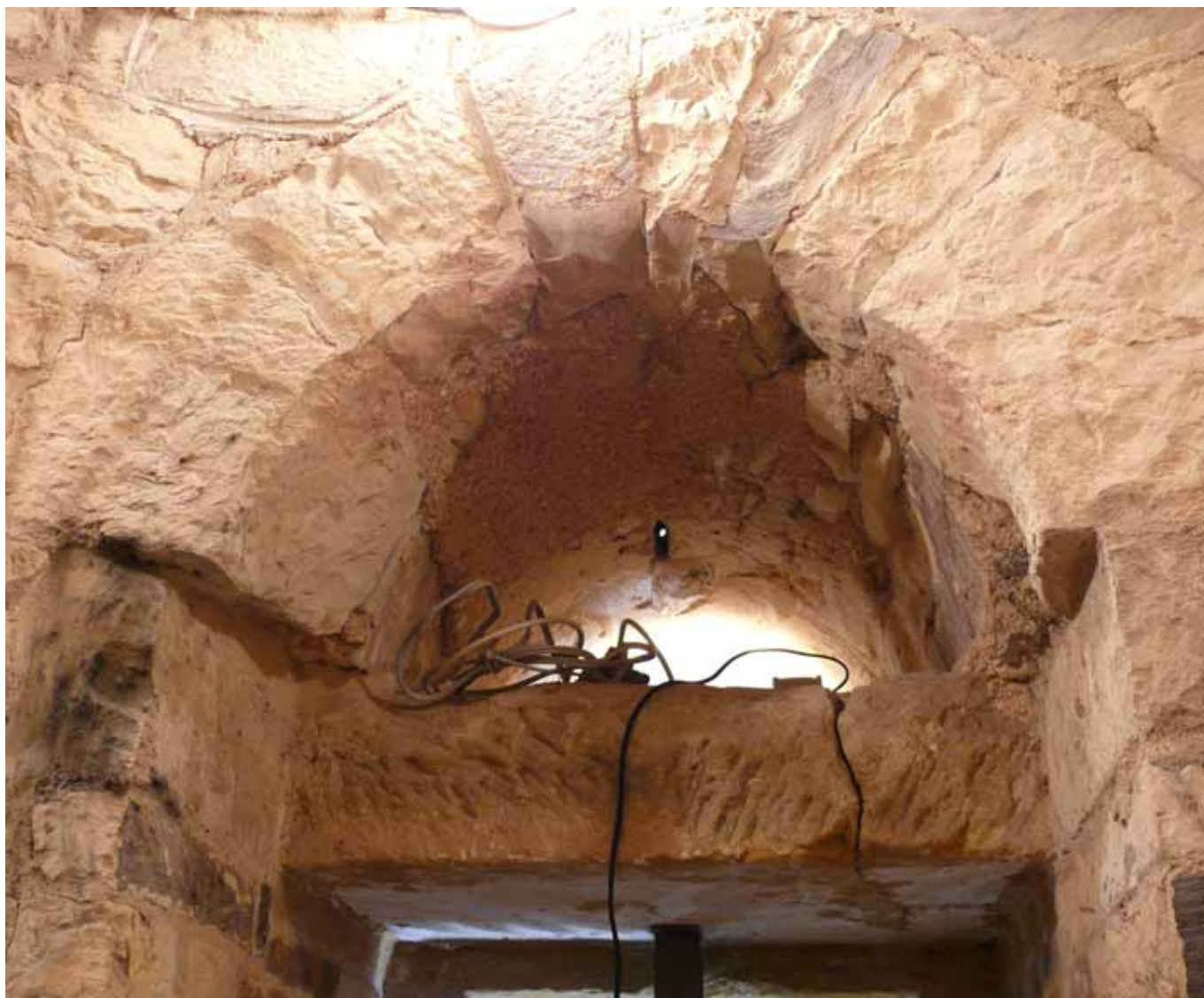
Obr. 8.9 – Rotunda sv. Jiří, detail záklenku vstupu z věže na zaniklou emporu, současný stav. Foto K. Nováček
