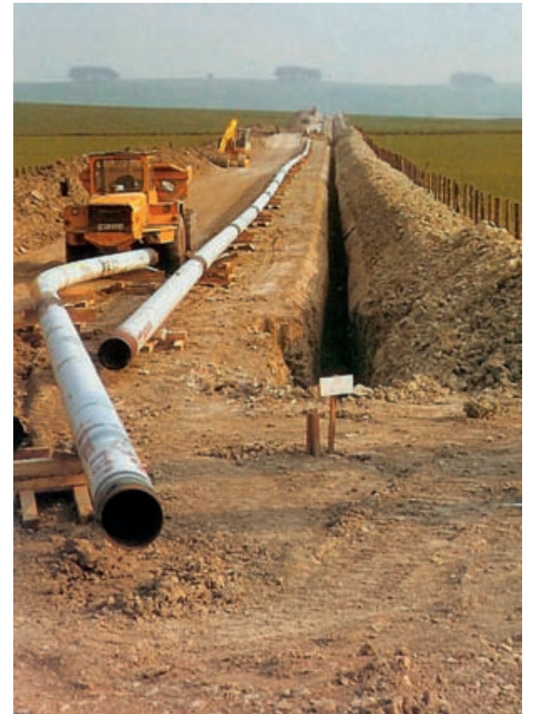
I-2. Dlouhé výkopy vedené napříč krajinou, do nichž jsou pokládány produktovody, jsou jedinečnou sondou do sídelní historie krajiny a přináší velké množství informací o charakteru, hustotě a struktuře pravěkého a raně historického osídlení prostoru, jímž tyto rýhy procházejí. Jsou proto důležitým zdrojem pro tvorbu archeologických map
