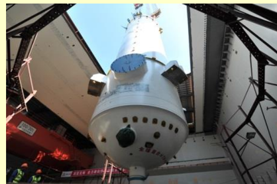
Instalace reaktoru HTR-PM v Číně
