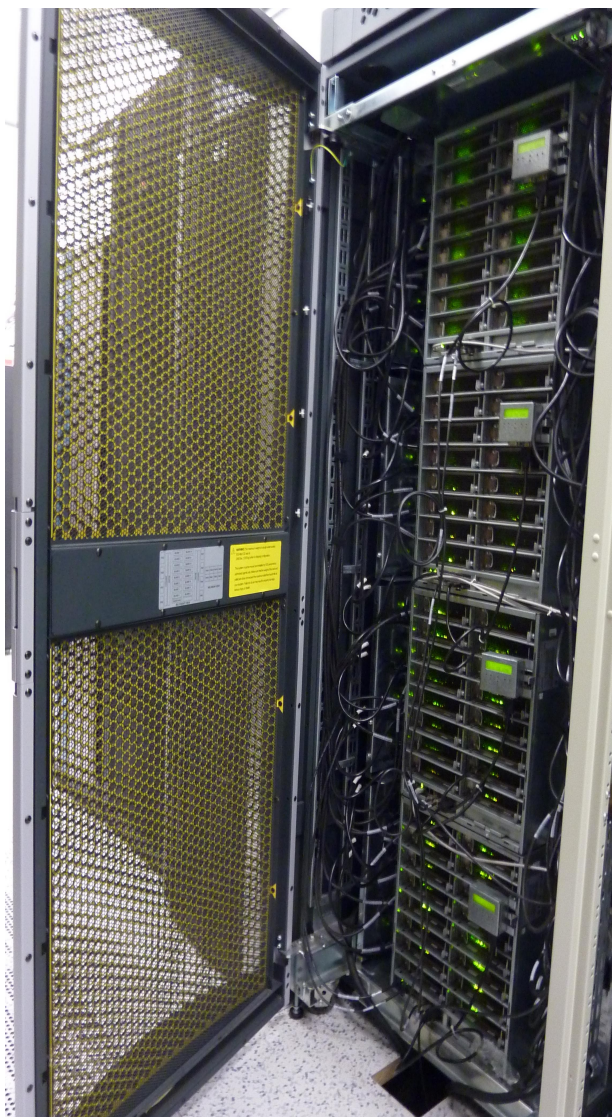
Obr. 1: Pohled do vnitřku racku
