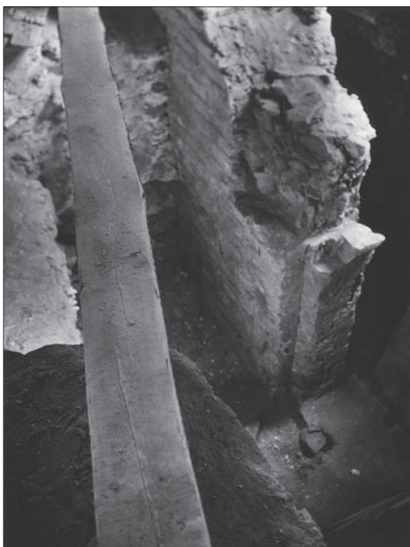
Obr. 98: Čp. 37, západní křídlo 1966. Románské zdivo s dochovaným křížovým pilířkem (vpravo), součást křídla severně od ambitu „kláštera kostela pražského“, archiv ARÚ Praha, Pražský hrad.
