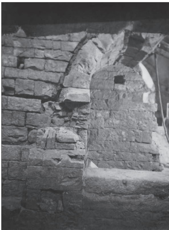
Obr. 114: Čp. 40, suterén 1965. Zaklenutá nika v románské kvádríkové hradbě s pískovcovým stupněm. Čelní pohled, archiv ARÚ Praha, Pražský hrad.
