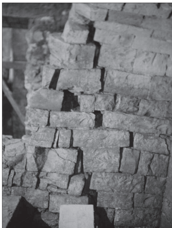
Obr. 117: Čp. 40, suterén 1965. Zaklenutá nika v románské kvádríkové hradbě s pískovcovým stupněm. Pohled na západní ostění niky se zdívem částečně odtrženým a ukloněným k severu do Jeleního příkopu, archiv ARÚ Praha, Pražský hrad.
