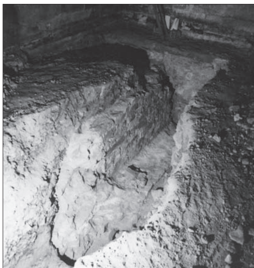
Obr. 53: Katedrála sv. Víta, stará sakristie 1986. Románské zdivo s předzákladem a narušeným nárožím. Foto J. Frolík, archiv ARÚ Praha, Pražský hrad.
