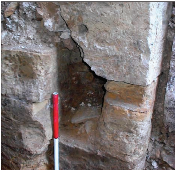
Obr. 80: Vikářská ulice 2000. Vchod do křídla „kláštera kostela pražského“, severní strana vstupu s otvorem pro závoru. Foto J. Frolík, archiv ARÚ Praha, Pražský hrad.
