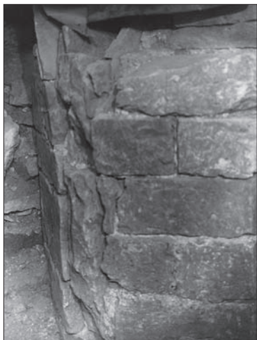
Obr. 100: Čp. 37, průjezd 1967. Východní zeď románského křídla severně od ambitu „kláštera kostela pražského“. Detail skoseného ostění okenního otvoru, archiv ARÚ Praha, Pražský hrad.
