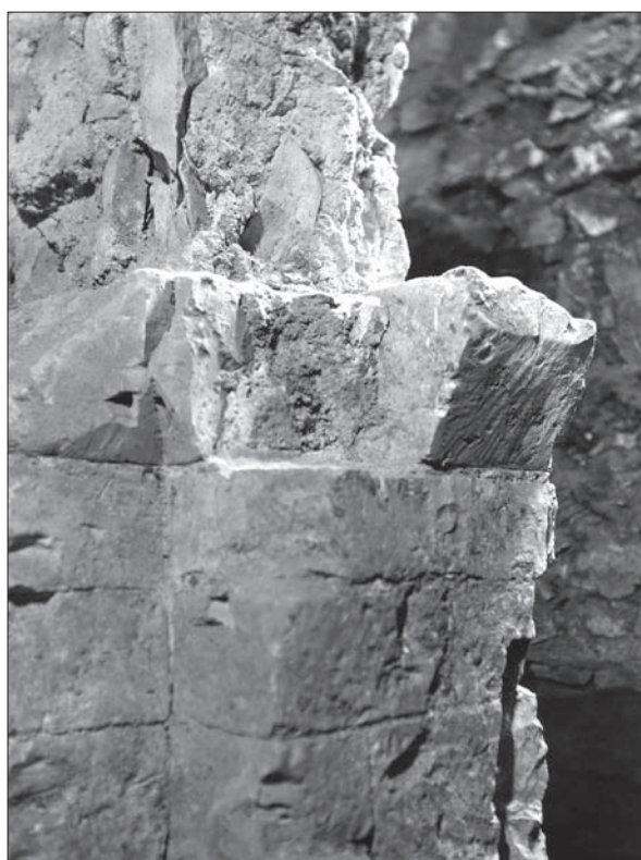
Obr. 99: Čp. 37, západní křídlo 1966. Románské zdivo s dochovaným křížovým pilířkem (vpravo), součást křídla severně od ambitu „kláštera kostela pražského“. Detail pilířku, archiv ARÚ Praha, Pražský hrad.
