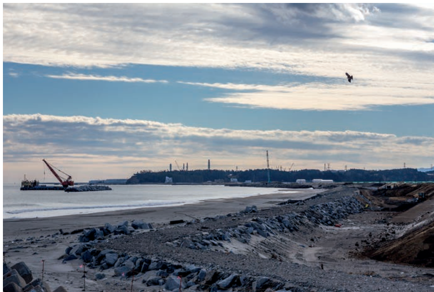
Jaderná elektrárna Fukušima Daiči, kterou v roce 2011 závažně poškodila vlna tsunami vyvolaná extrémně silným zemětřesením. Práce zde pokračují dodnes.
