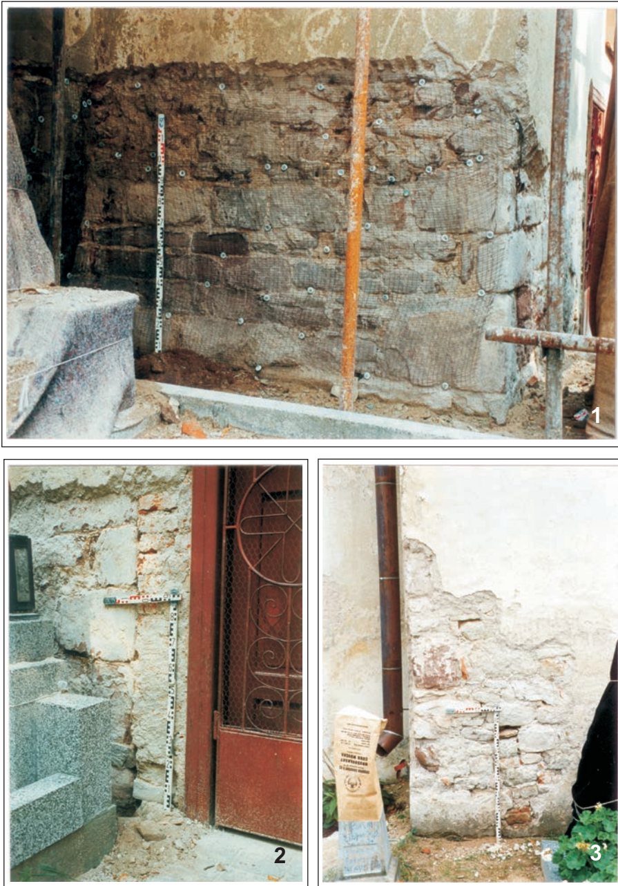
Obr. 3. Rokytná, kostel sv. Leopolda. 1 – zdivo JZ nároží lodi, 2 – zdivo Z ostění vstupu do lodi na J straně, 3 – zdivo SV nároží lodi. Foto R. Procházka.
